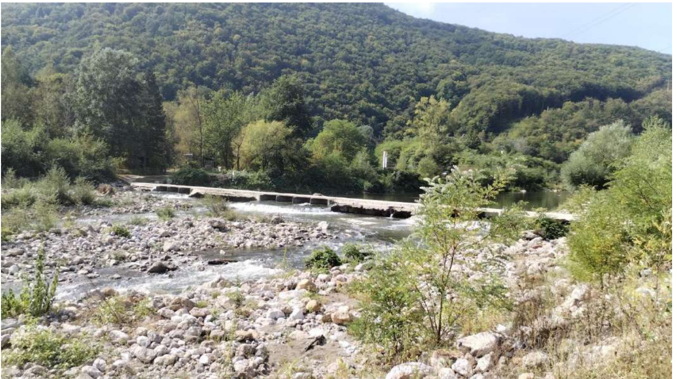
Слика 7 Нанос у корити Западне Мораве и пропуст/мост који везује Овчар Бању и насеље Дучаловићи
